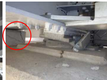
写真-6 支承の破損の状況
