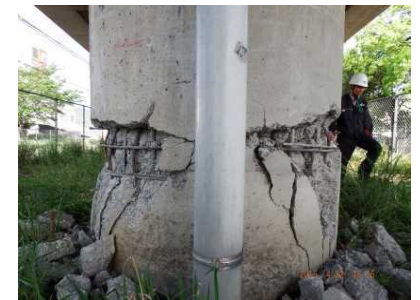
写真-7 段落し部の損傷 ちゅうおうせんりつきょう 市道(1-3)中央線・中央線陸橋
