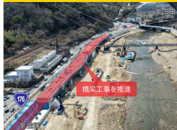
国道176号の幅員を広げるために橋梁工事を推進しています。
