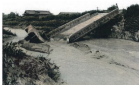
千里川 下走井橋被害状況
