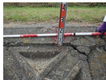
低水護岸の老朽化（沈下）
