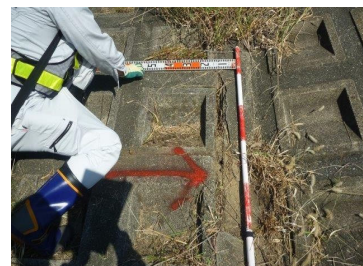
高水護岸の老朽化（目地の破損）
