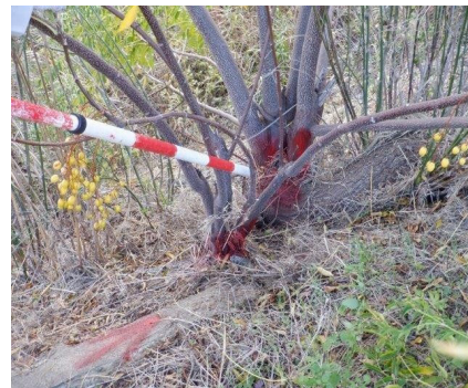
樹木による低水護岸(張ブロック)の変状
