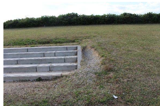
観覧席護岸横の堤防損傷
