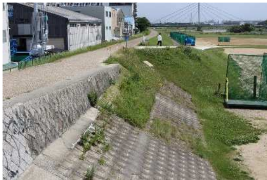
③堤防表法の踏み荒らしの状況
