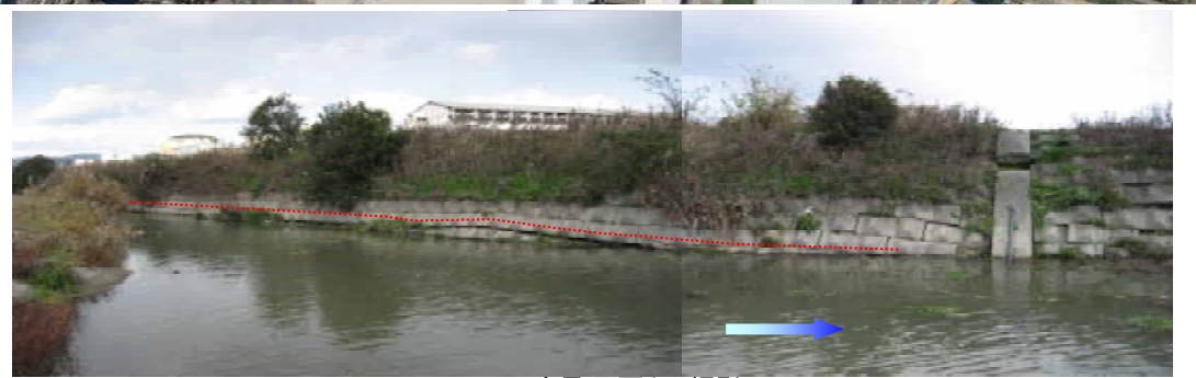
全景(正面から撮影) 連節ブロックにたわみあり
