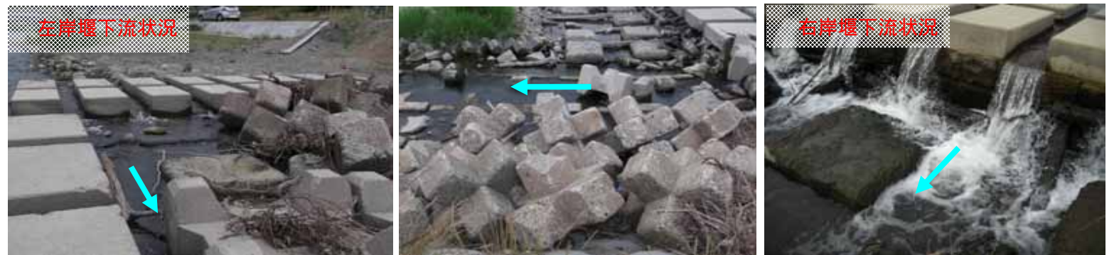
・右岸側より左岸側の方が堰との落差が小さい
