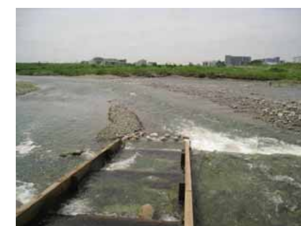
魚道下流端付近 魚道への誘導は十分でない。
