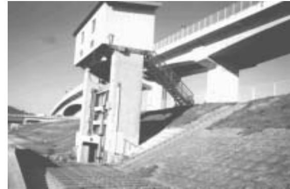
神田排水樋門
