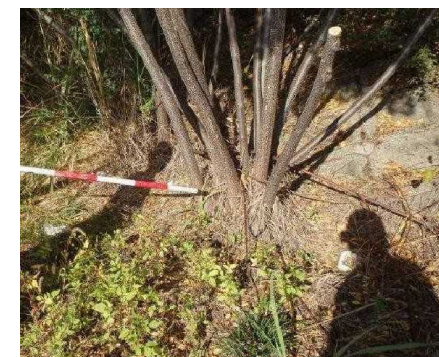
▲護岸への樹木侵入
