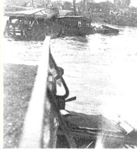
真二つに折れた神崎橋
