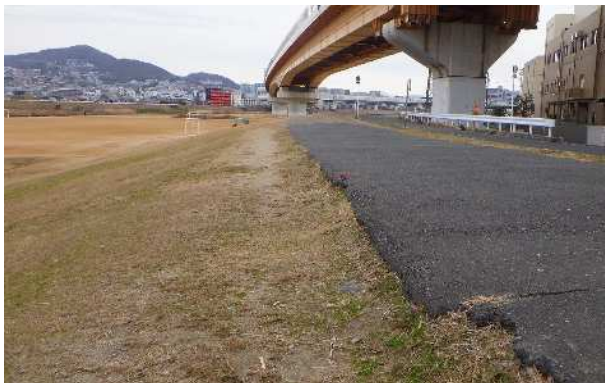
天端付近の踏み荒らしの状況 (9.6k+100m 付近)
