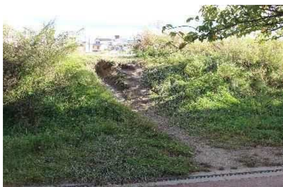
⑤公園隣接堤防裏法の損傷
