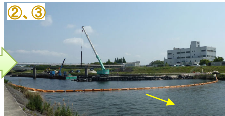
現地状況 (R7工事実施箇所1.2k付近) (令和7年5月20日撮影: 工事中)
