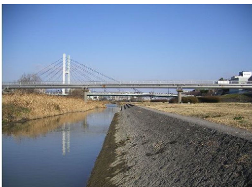
図 1.2.1 低水護岸整備に伴う水陸移行帯の消失
