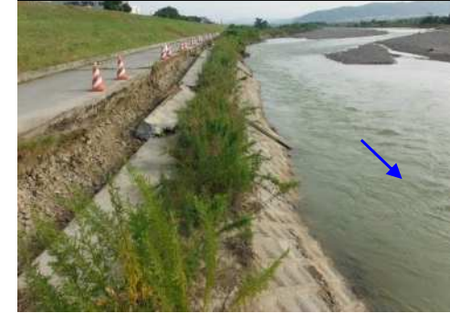
写真① 被災箇所下流 右岸から上流河道を望む (平成30年7月12日撮影)
