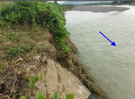
写真② 被災箇所上流 右岸から上流河道を望む (平成30年7月12日撮影)
