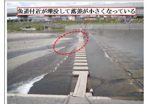
埋没後(平成29年月) 魚道の埋没状況
