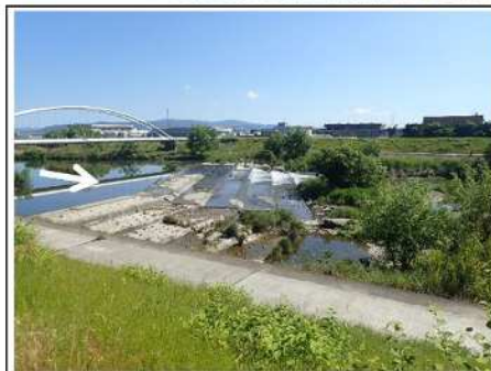
大井井堰(葦川4.0km付近)
