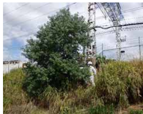
▲堤防への樹木侵入
