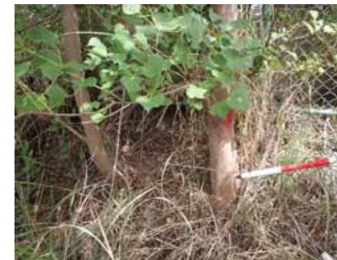
▲堤防への樹木侵入
