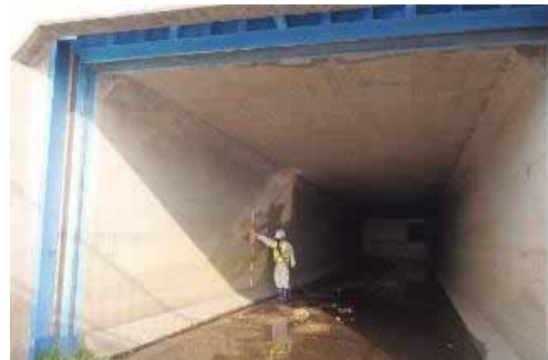
▲樋門のひび割れを点検
