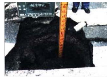
【写真－18】下水道管の破損による道路陥没 (資料：東京都下水道局)
