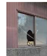
窓が割れた管理不全空家
