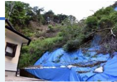
豪雨の度に 土砂崩れが多発
