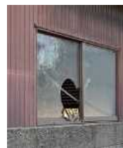
窓が割れた 管理不全空家
