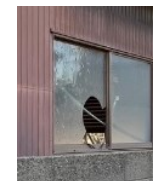
窓が割れた管理不全空家
