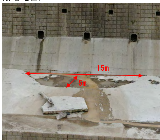
(c) 2号堰堤 水叩き（洗掘）拡大正面
