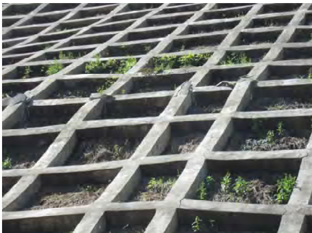
法枠コンクリートの損傷状況
