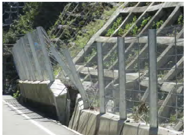
擁壁の損傷状況
