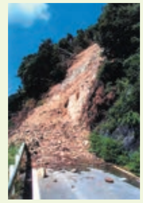
土砂崩落（竹岡付近）
