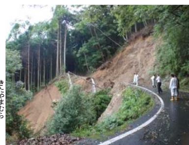
▲土砂崩落の状況
