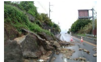
写真1 法面崩落状況（串本町和深地先）
