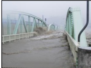
【写真①】熊野大橋の越水状況（H23.9月 台風12号）
