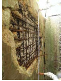
内部の鉄筋が露出した橋梁
