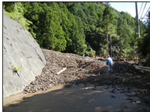
国道425号線の土砂流出状況
