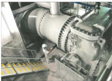
雨水ポンプの整備
