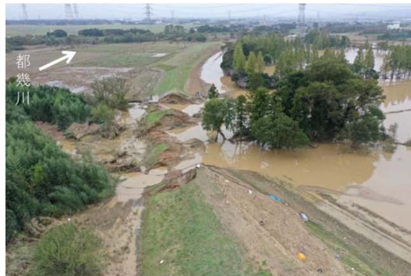
都幾川0.4km右岸 決壊箇所
