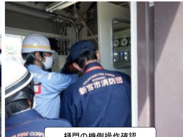
樋門の機側操作確認
