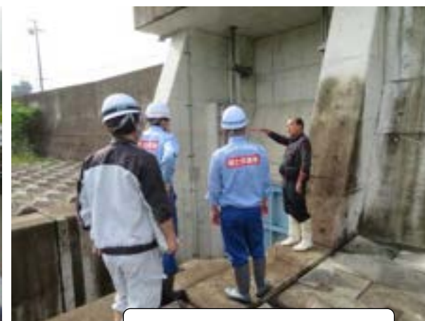
不具合箇所確認
