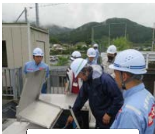
不具合箇所確認
