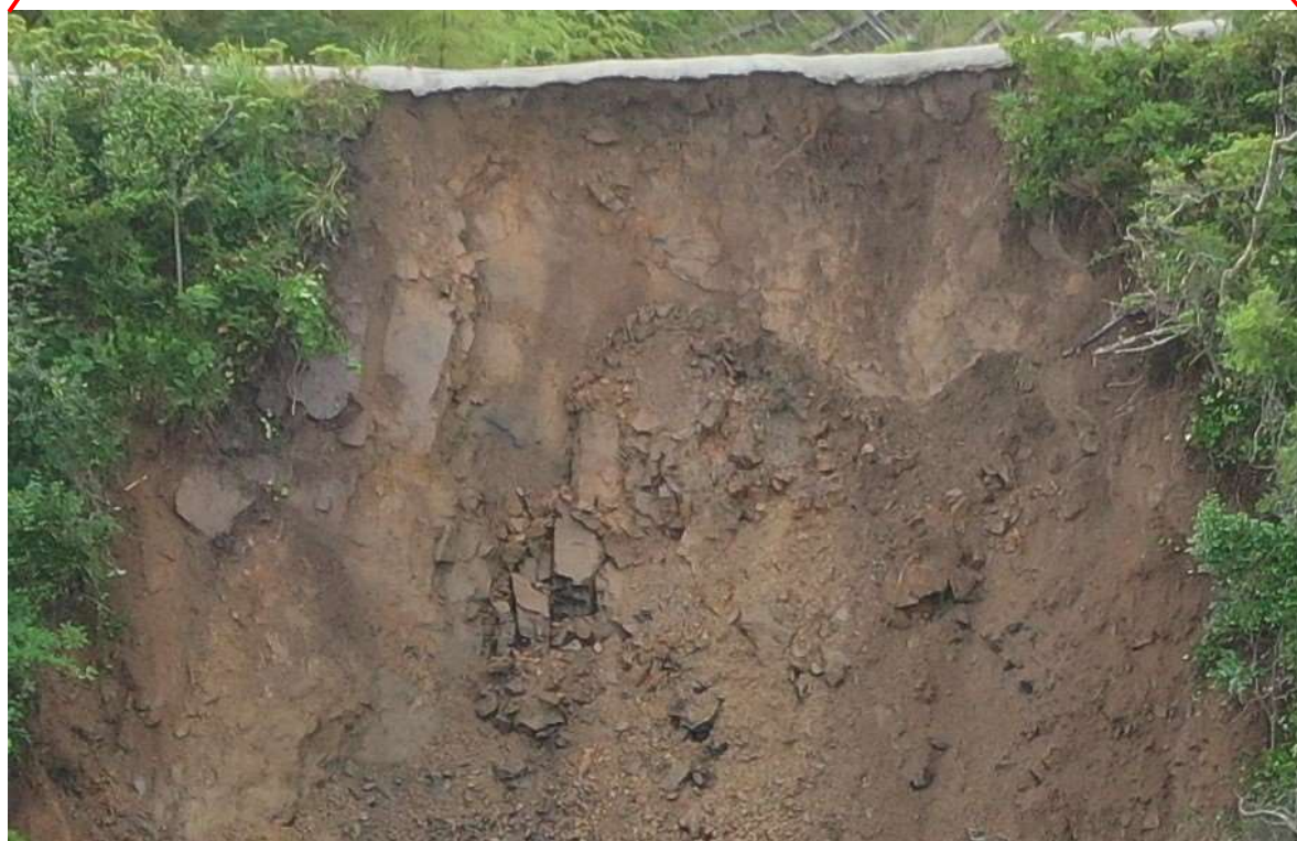
○崩土発生範囲の法面上部、不安定な土塊(2022. 6. 27 AM6時頃)
