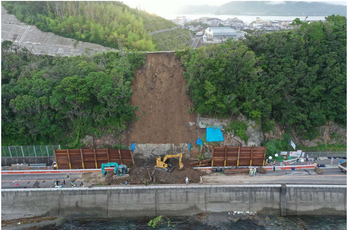
○法面崩土の状況(2022. 6. 27 AM6時頃)
