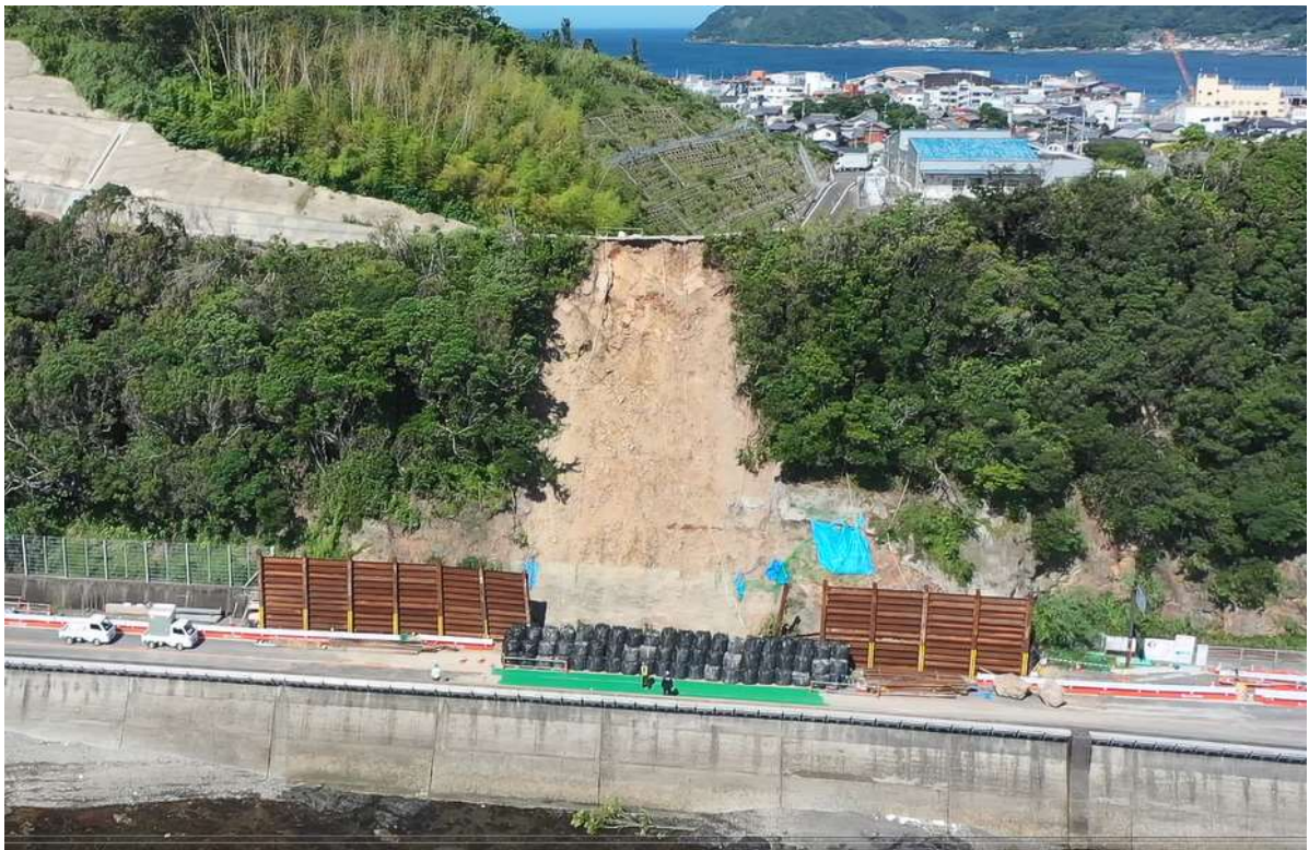
○路面上の土砂、土塊除去(2022. 6. 28 PM3時頃)
