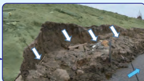
河川巡視①(洗掘・漏水・法崩れ発見)
