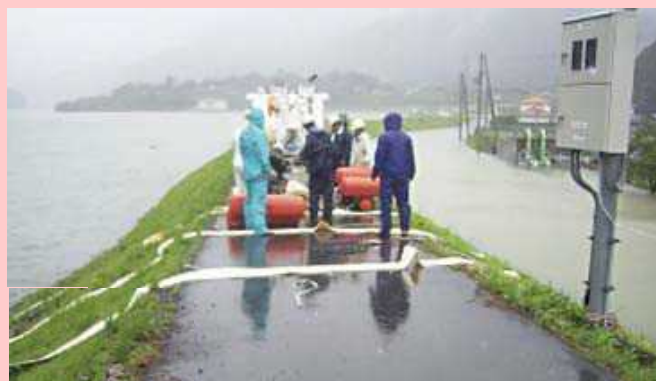
台風6号での稼働状況 (堤防天端)
