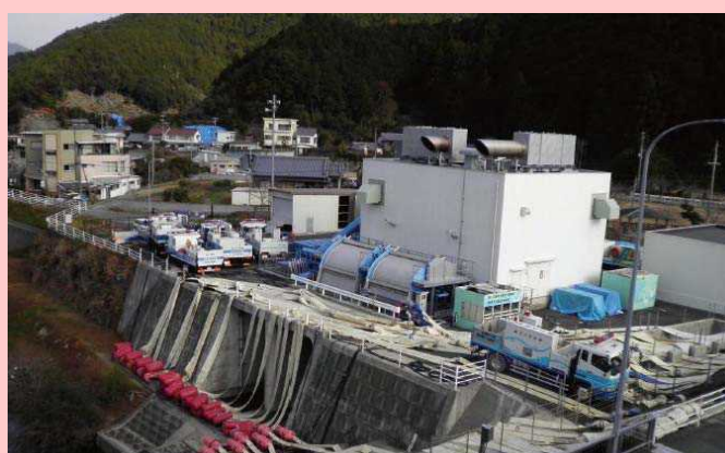
被災した相野谷川排水機場に緊急対策として配備された排水ポンプ車
