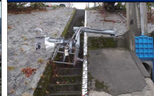
倒壊した新宮市船町の監視カメラ
