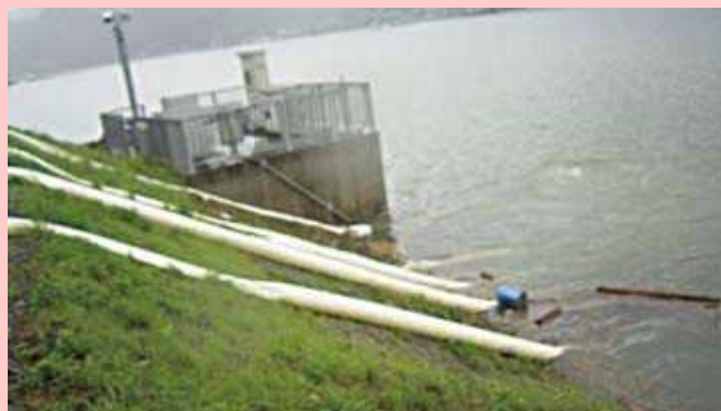
台風6号での稼働状況 (吐出し側:堤外側)
