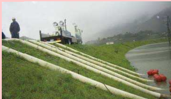
台風6号での稼働状況 (吸込み側:堤内側)
