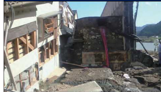
高岡輪中堤の転倒で切断された光ケーブル
