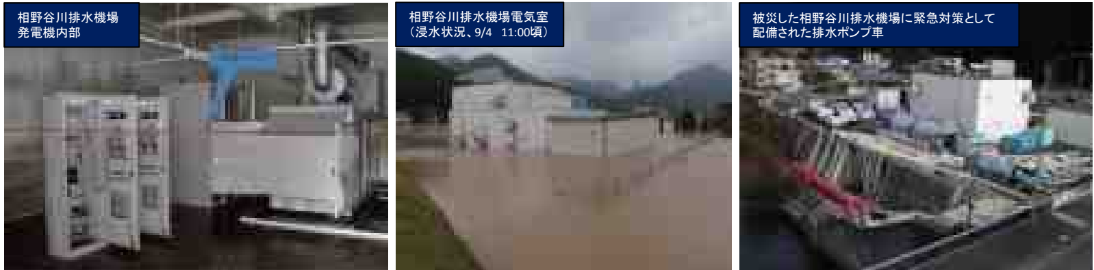
平成23年紀伊半島大水害:相野谷川排水機場の被害状況
