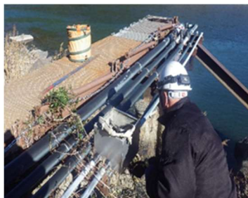
採水ポンプ配管の点検
