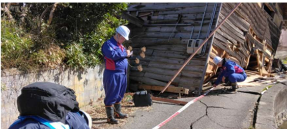
輪島市での被災状況調査
