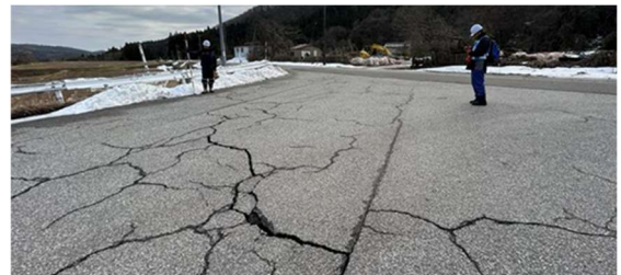
珠洲市での被災状況調査
