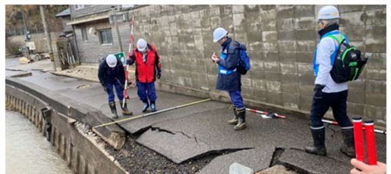
輪島市での被災状況調査
