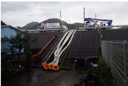
排水ポンプ車配備状況（新宮市）
