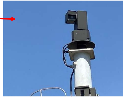
CCTV設備（拡大写真）
