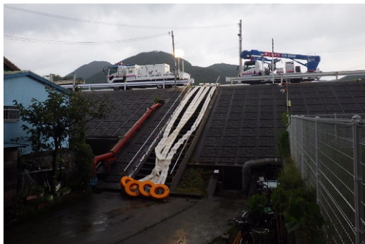
排水ポンプ車配備状況(新宮市)
