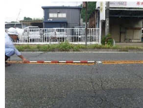
堤防天端の沈下状況
