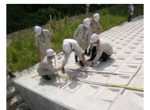
沈下・陥没の確認
