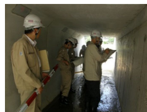
露筋・漏水の確認
