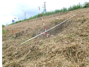
堤防のり面の陥没状況
