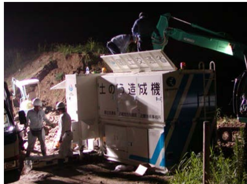
土のう造成作業による緊急水防対策(奈良県大和郡山市) (H18.7)
