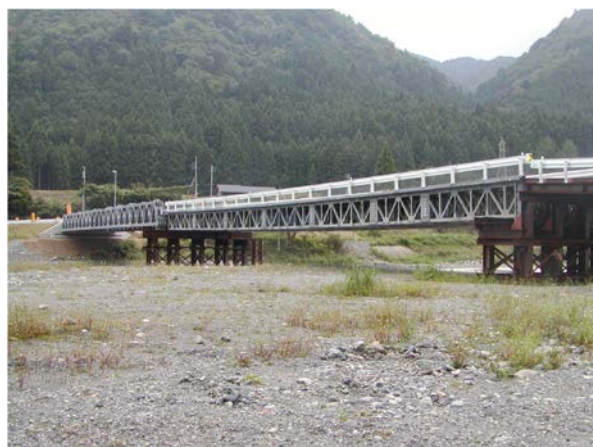
のり面崩落による迂回路として使用(滋賀県高島市) (H18.6～H21.5)
