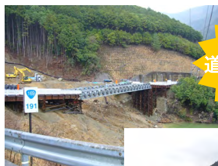
土砂崩れにより道路が被災
