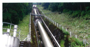
【西吉野第一発電所】
