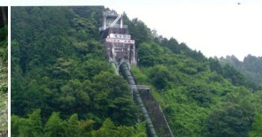
【西吉野第二発電所】
