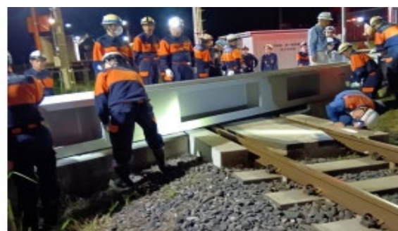
陸閘閉鎖(ゲート閉鎖)
